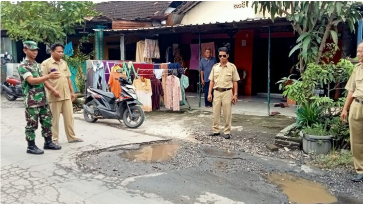
Jalan Rusak, Babinsa Wonosari Cek Kondisi Jalan Bersama Pemdes
